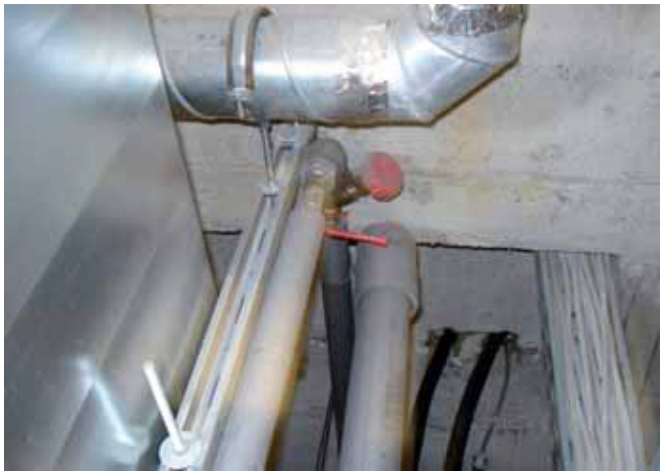
Μη εμφανές κλειστό κύκλωμα στο σύστημα κυκλοφορίας θερμού ύδατος που ευνοούσε την ανάπτυξη λεγεωνέλλας – Πηγή: OMF
