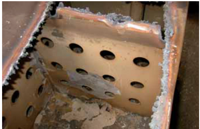
Ίζημα και υπολείμματα στα τοιχώματα και στον πυθμένα δεξαμενής νερού – Πηγή: ISPEL
